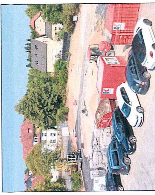
Der Parkplatz der Gemeindeverwaltung über dem neuen Mischwassersammelbecken steht bald wieder zur Verfügung.
