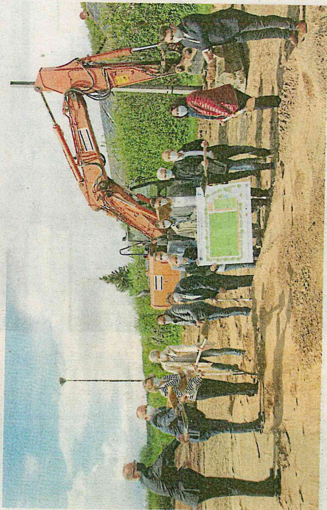
Großer Bahnhof für den Kunstrasen: NRW-Heimatministerin Ina Scharrenbach (Dritte von links) mit Vertretern von Politik, Verwaltung und Sport sowie Planern und Mitarbeitern der Baufirma beim ersten Spatenstich in Langenholzhausen.
