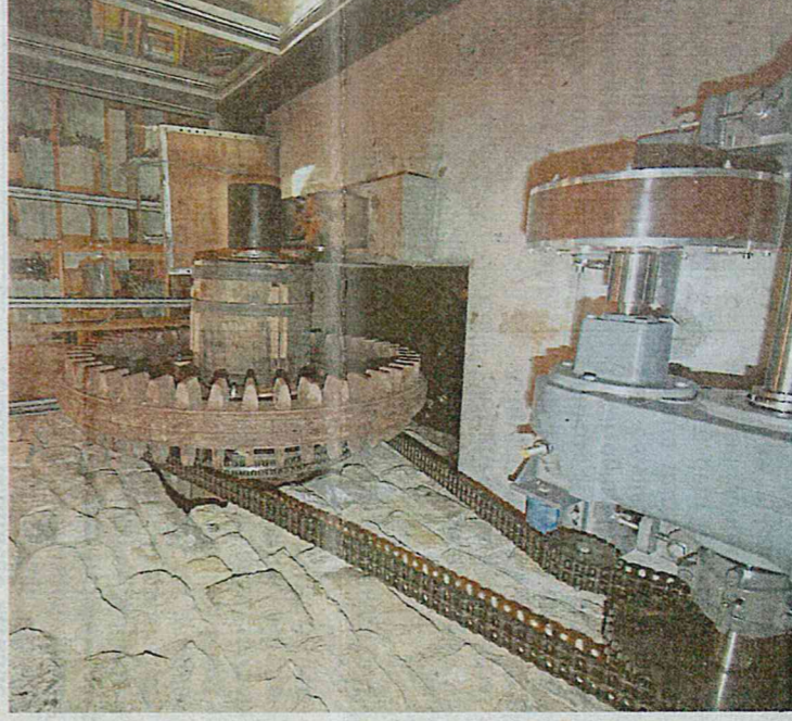
Das hölzerne Kammrad überträgt die Drehung des Wasserrades über eine Kette auf den Generator Foto: Jürgen Gebhard
